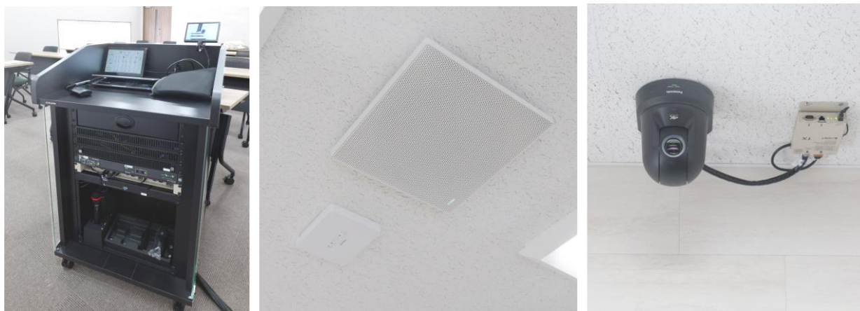
▲ 機器ラック (標準的な業務用機器で構成・整然と配線) ・天井マイク・天吊り PTZ カメラ
